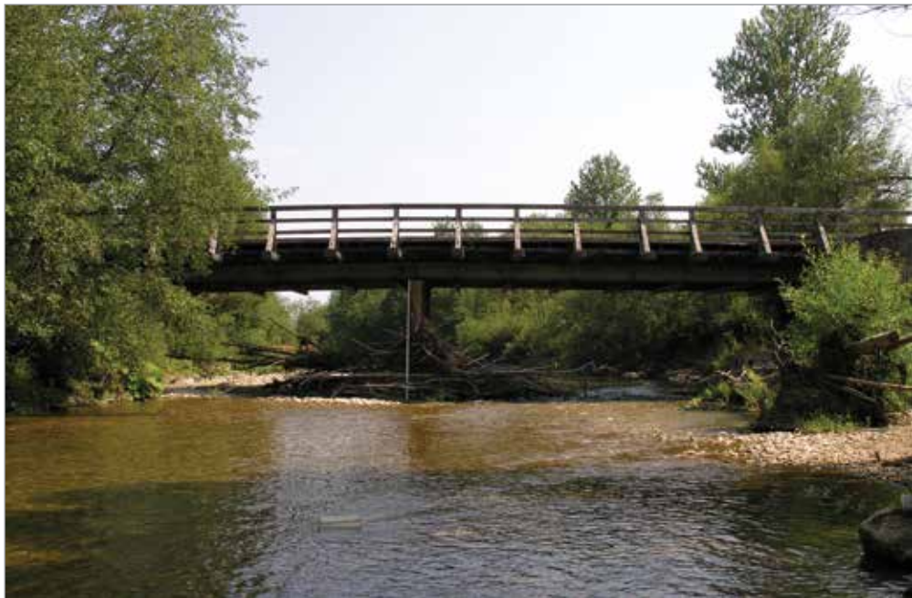
Fot. 3. Most na Czarnym Dunajcu w Długopolu może łatwo zostać zablokowany przez napławiony w czasie powodzi rumosz drzewny. Sprzyja temu niewielka szerokość koryta i obecność filaru w jego obrębie Fot. Bartłomiej Wyżga
