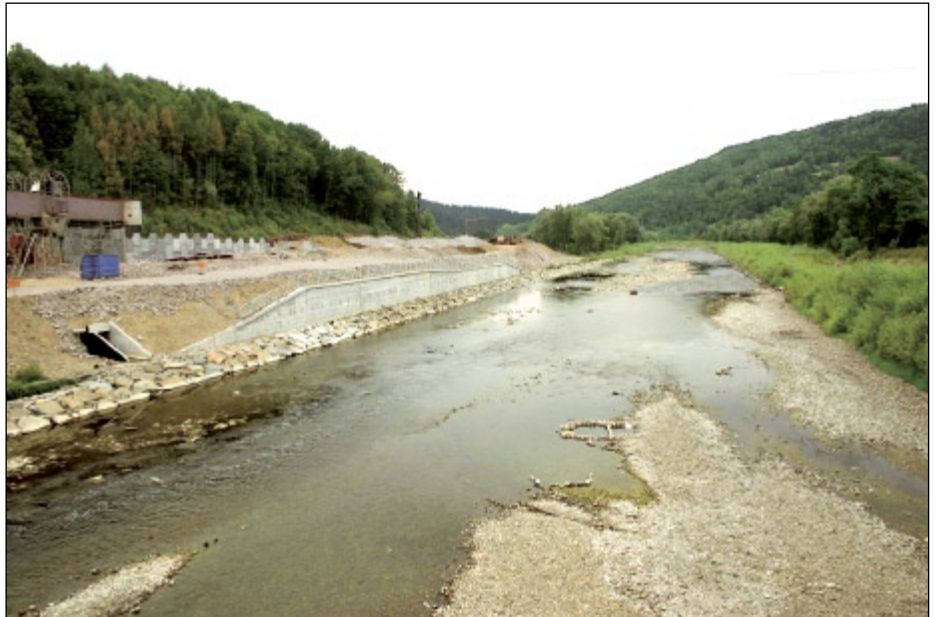
Fot. 1. Przykład zniszczenia Raby w Stróży. Droga zabiera rzece dolinę, rzeka traci terasę do odkładania rumowiska, energia wody przyspieszy erozję wgłębną, rzeka otrzyma spływy pyłu gumowego i węglowodorów z powierzchni jezdni, cenne gatunki ryb opuszczą zdegradowany odcinek rzeki, zawężona dolina zwiększy zagrożenie powodziowe prawego brzegu. Niezaccieniona woda nagrzewa się do temperatur śmiertelnych dla ryb łososiowatych. Utrata ciągłości między ekosystemami leśnymi z powodu braku przejść dla zwierząt
