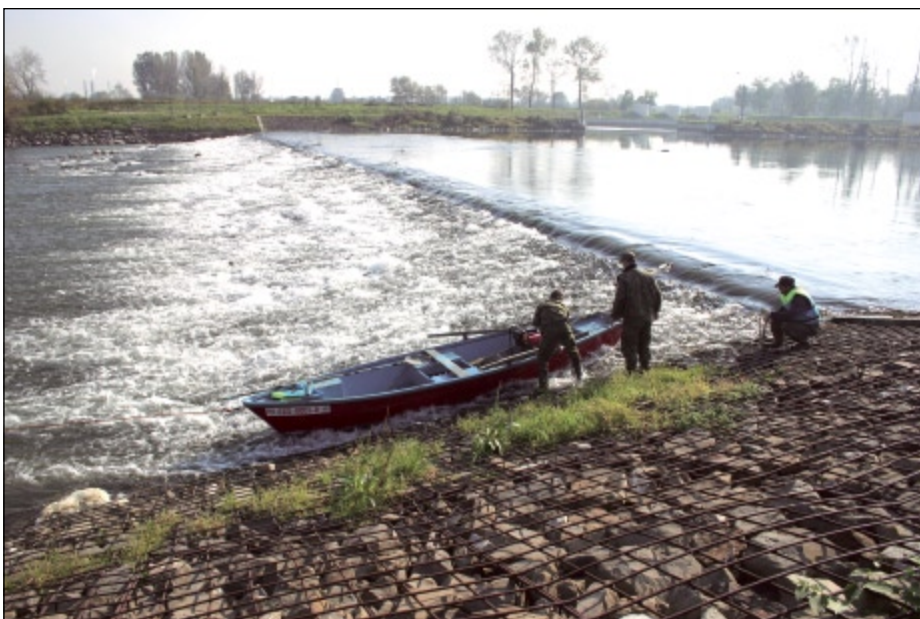
Fot. 2. Próg na Dunajcu poniżej Tarnowa. Kamienny narzut zamknięty w spawanej kratownicy stalowych prętów tworzy pochylnię nieprzekraczalną dla ryb. Przykład niekompetencji projektantów i decydentów
