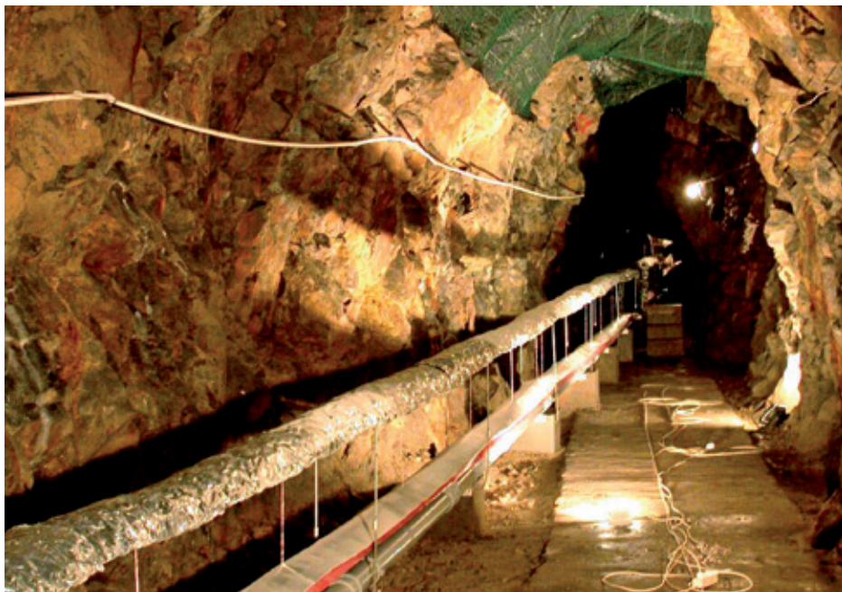
Klinometr hydrostatyczny 0304 akwedukt
