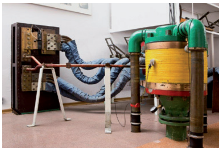
Magnes typu Bittera wytwarzający pole magnetyczne o indukcji do 15 T w otworze o średnicy 34 mm. Miedziane przewody (w niebieskiej izolacji) doprowadzają o natężeniu do 8 000 A, a miedziane i zielone rury to instalacja wodna chłodząca magnes.
